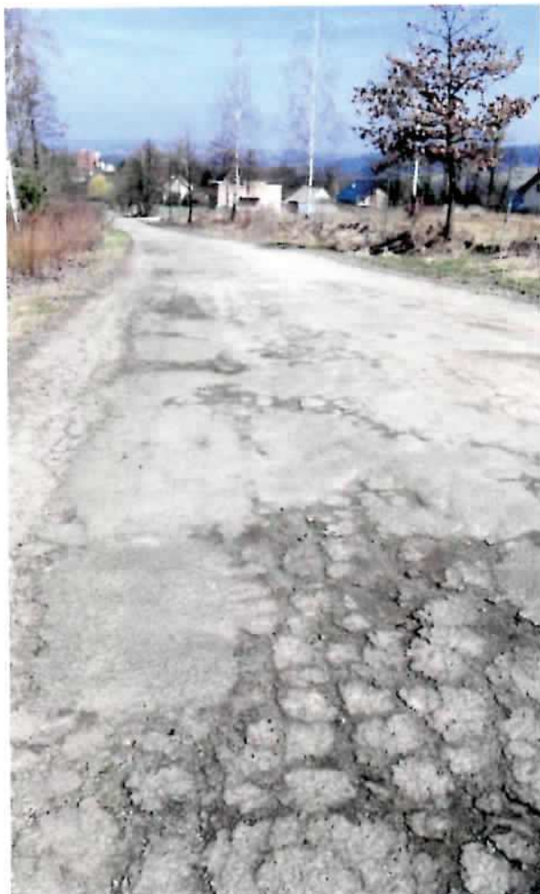
Fot. 5 Fotografia obecnego stanu nawierzchni drogi K1931 z dn. 30.03.2019 r.
