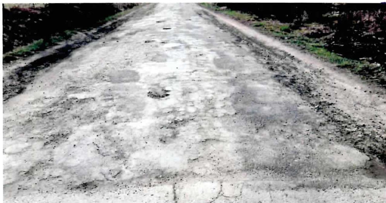
Fot. 1 Fotografia obecnego stanu nawierzchni drogi K1931 z dn. 30.03.2019 r.
