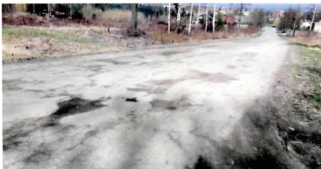
Fot. 7 Fotografia obecnego stanu nawierzchni drogi K1931 z dn. 30.03.2019 r.
