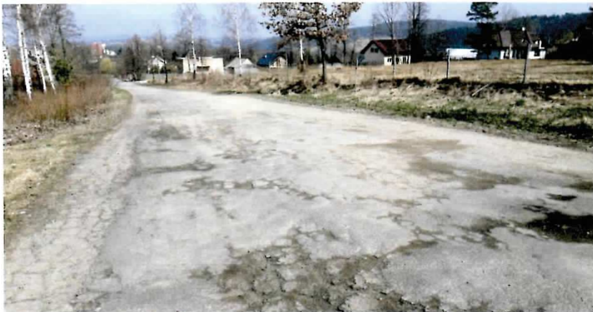
Fot. 8 Fotografia obecnego stanu nawierzchni drogi K1931 z dn. 30.03.2019 r.
