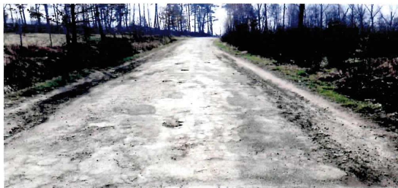
Fot. 2 Fotografia obecnego stanu nawierzchni drogi K1931 z dn. 30.03.2019 r.
